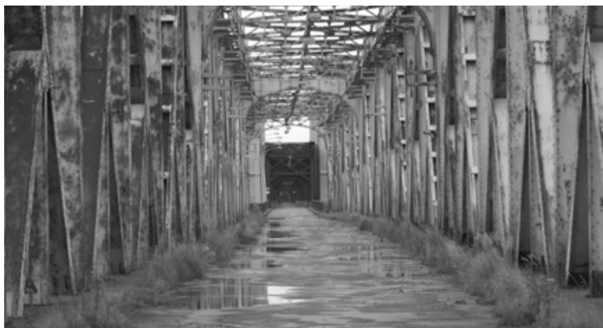
Stan techniczny mostu drogowego po zamknięciu
